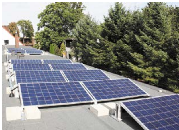
Instalacja fotowoltaiczna na dachu przedszkola w Gwiazdowie Fot. Gmina Sławno
