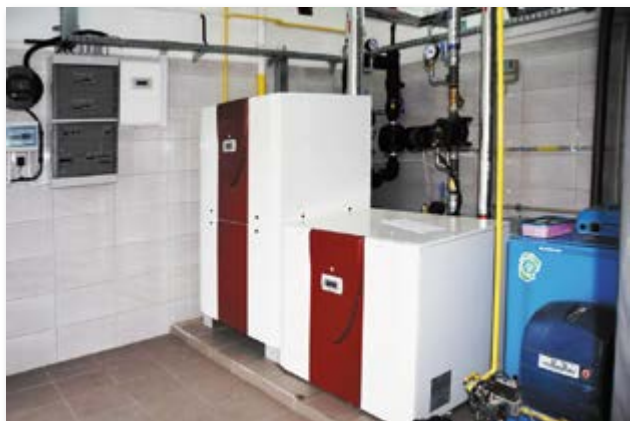
Pompa ciepła solanka/woda (szkoła w Warszkwie)
