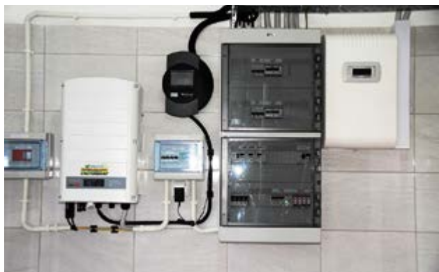
Sterowanie i okablowanie maszynowni węzła cieplnego z pompami ciepła Fot. Gmina Sławno
