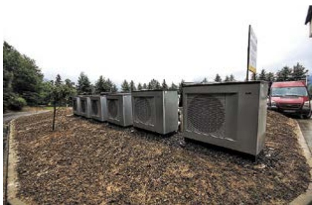
Kaskada pomp ciepła w Uzdrawisku „Biawena” (Wysowa-Zdrój) Fot. NIBE
